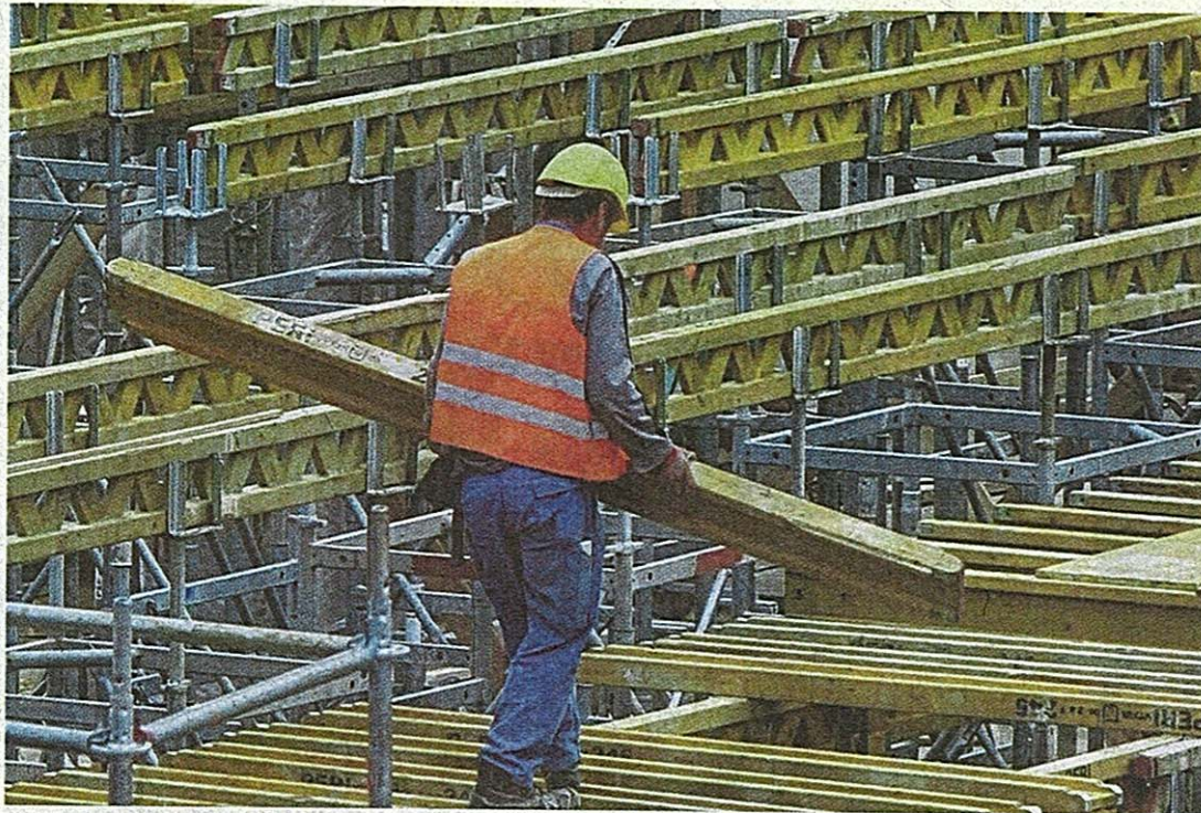
Die Baubranche in Nordbaden hat nach dem langen Winter wieder gut zu tun.
