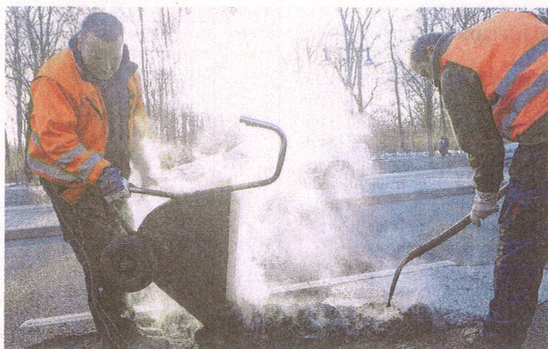
Straßen ausbessern ist, zumal im Winter, eine kostspielige Angelegenheit. Vertreter der Bauwirtschaft fordern mehr Geld dafür und regen eine Privatisierung an. FOTO: DPA
